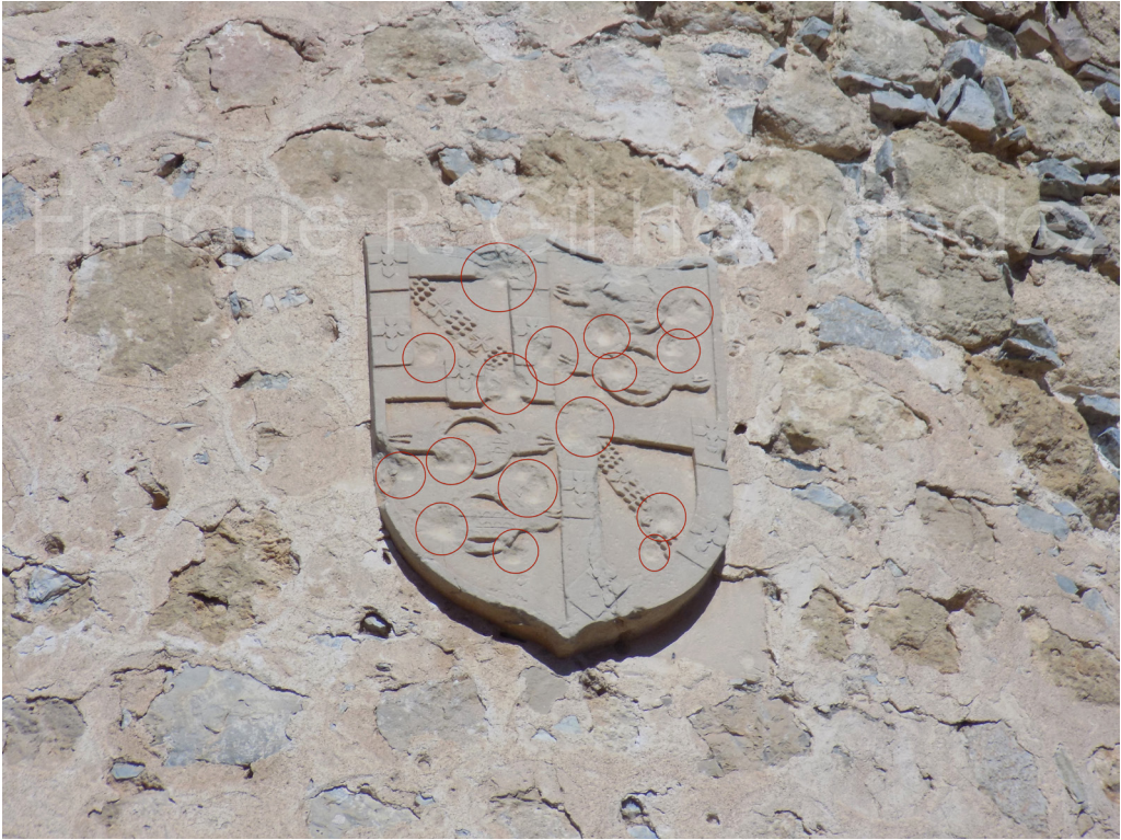
Figura 5. En el escudo nobiliario ubicado en la torre T10 se puede observar una alta concentración de impactos efectuados por arma de fuego.
